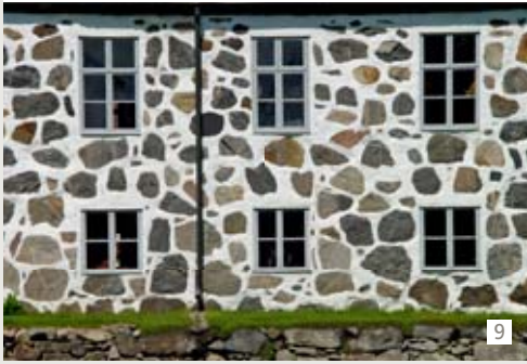
9 Bien qu'elles soient de très grand format, les pierres semblent flotter dans la blancheur du mortier. BÂTIMENT TRADITIONNEL, SUÈDE
